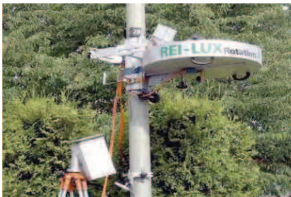
Photo 10 : contrôle potence ou grand mât – Source : REI-LUX
