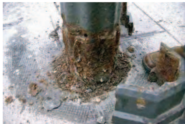
Photo 4 : corrosion (2) – Source : REI-LUX
