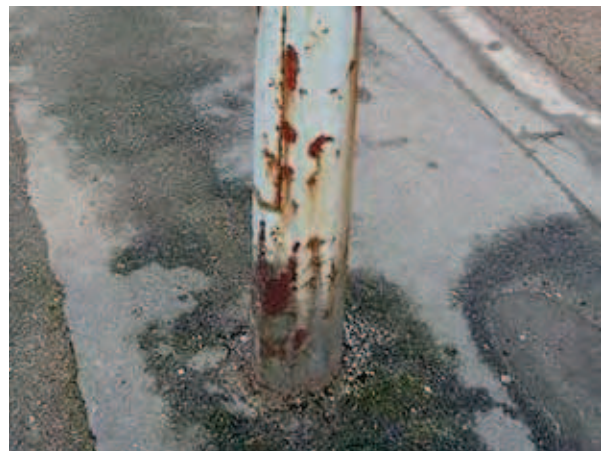
Photo 3 : corrosion (1) – Source : REI-LUX
